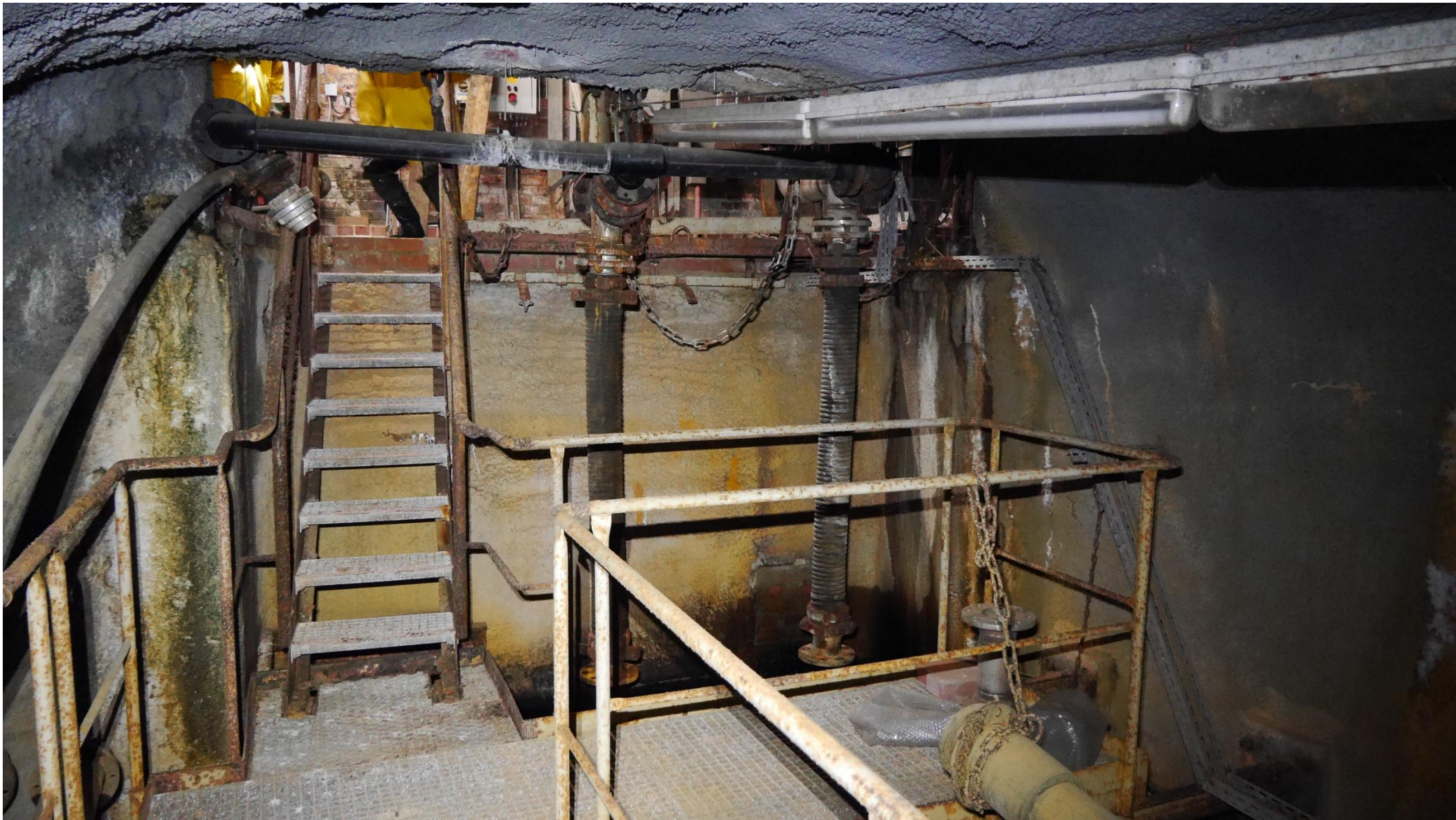
Wasserhaltung im Turbinenschacht 2003, Zustand 2026. Beide Wasserhaltungspumpen wurden entfernt.
